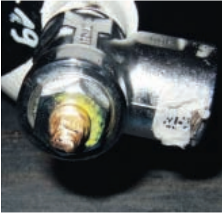
Im Detail - das beschädigte Flaschenventil
