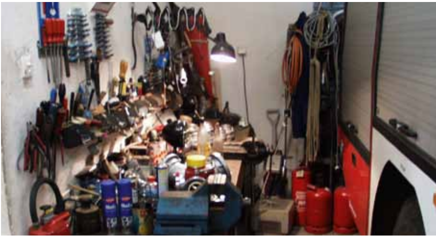
Unzulässige Lagerung von verschiedenen Gefahrstoffen in der „Werkstattecke“ eines Feuerwehrhauses
