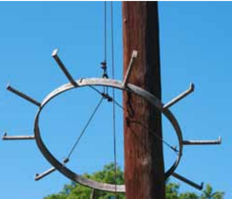
Unzulässige Drahtseilverbindungen sowie Schlauchaufnahme ohne Schlauchbefestigung
