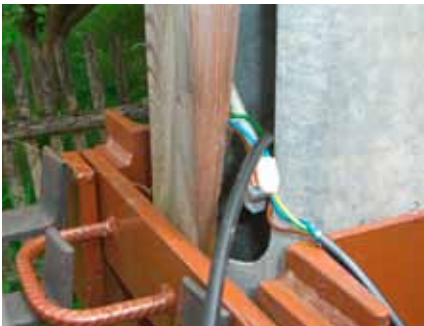
Nicht ordnungsgemäß ausgeführter elektrischer Windenanschluß
