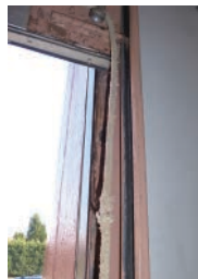
Dieses Tor wurde vermutlich noch nie gewartet.
