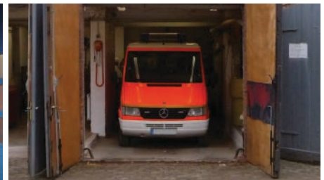
Die Tore sind in sehr schlechtem Zustand. Zudem besteht Quetschgefahr zwischen benachbarten Torflügeln.
