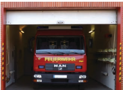
Dieses Tor ist nach dem Öffnen nicht in der Endstellung geblieben.
