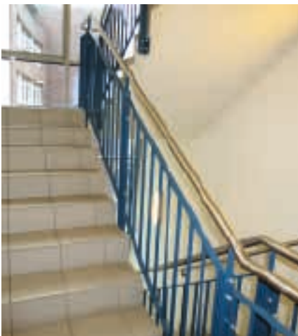
» Ein Treppenhaus im Feuerwehrhaus kann Gefahren für kleinere Kinder bergen.
