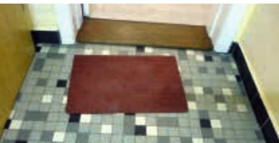
► Die Rutschpartie auf dem Fußabtreter im Alarmeingang kann mit einer schweren Verletzung enden – kleine Unfallursache, große Wirkung!
